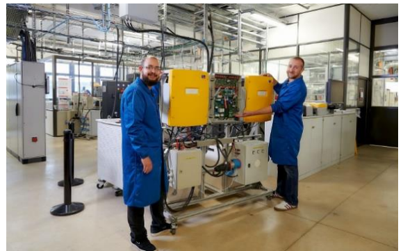
Zone de simulation de micro-réseau de production / consommation électrique et photovoltaïque
