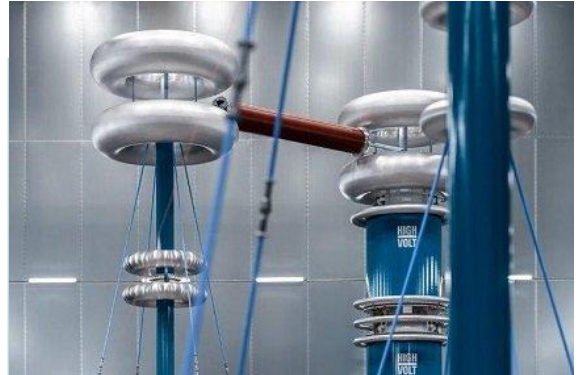
Equipements haute tension de la plateforme faradisée
