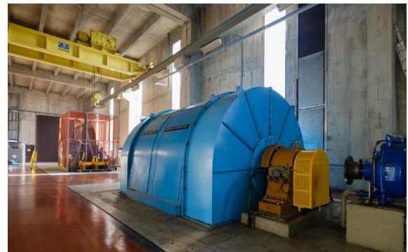
Hall machines : alternateurs 20 MVA et 400 MVA
