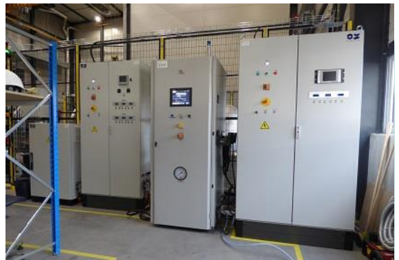
Armoires de contrôle de la plateforme
