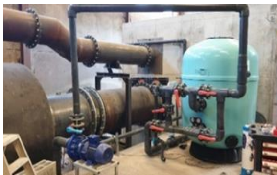
Jonction réseau de conduite/bassin du CEERIC et système de filtration
