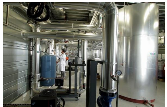
Réseau de chaleur expérimental. Intérieur de la chaufferie
