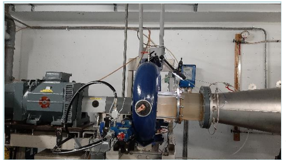
Turbine Francis et son alternateur synchrone en mode charge îloté
